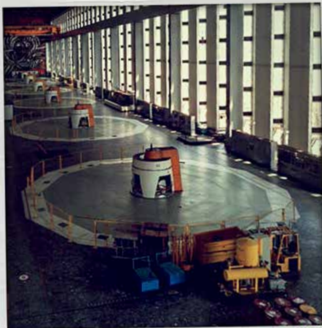
La salle des machines du barrage des Portes de Fer
